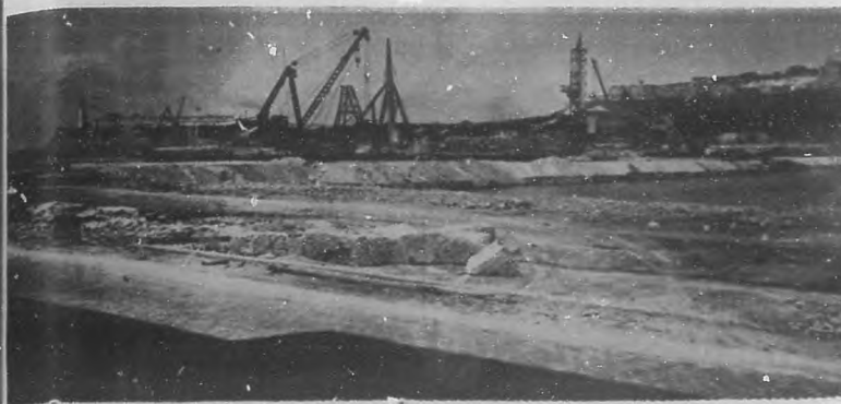
Aspecto parcial de las obras de desalcance y relleno que se efectúan actualmente a la entrada de nuestro puerto.
